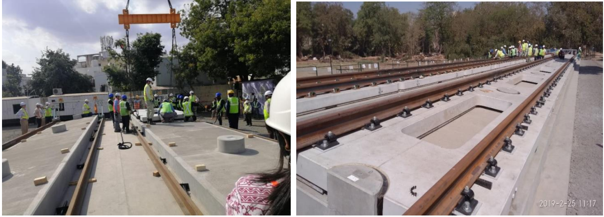
एचएसआर ट्रेनिंग इंस्टीट्यूट, वडादोरा में स्लैब ट्रैक के साथ ट्रेनिंग लाइन बिछाना
