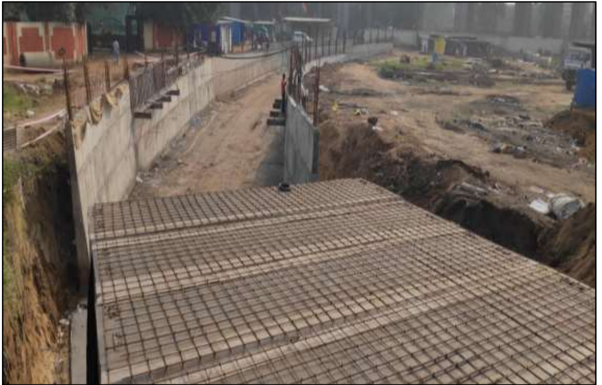
पुल 1 के तहत सड़क - निर्माणाधीन - चिमनभाई पुल की ओर जाने का रास्ता, अहमदाबाद, गुजरात
